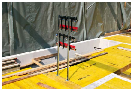
... an den Heizkreisverteiler.
